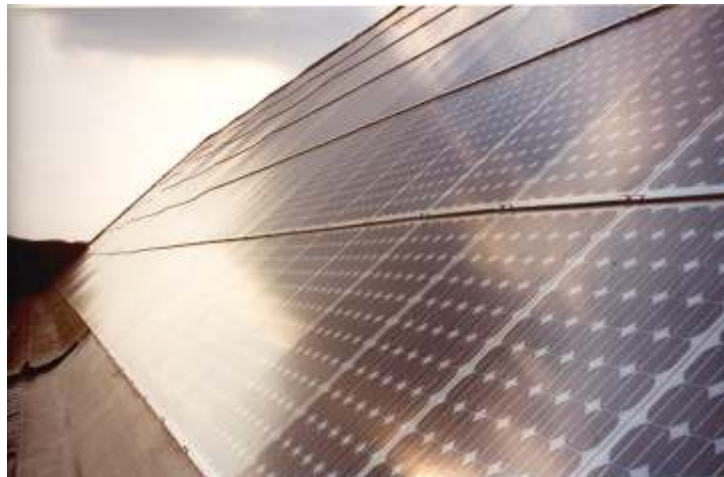
Abb. 21: Anordnung der Zellen auf einer Dachfläche
