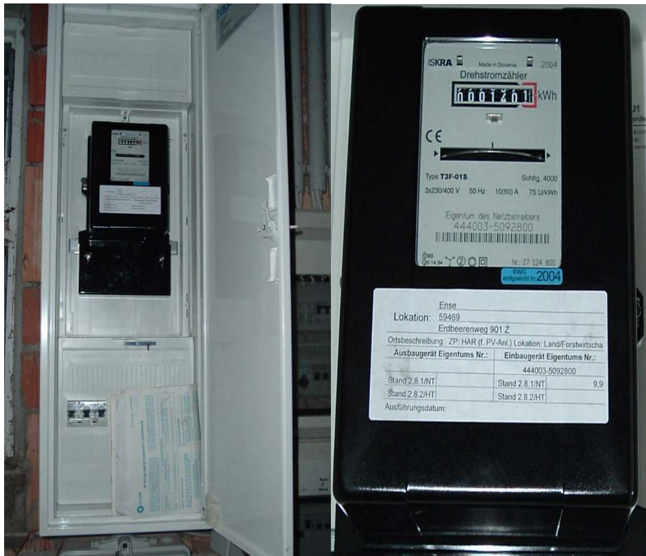
Abb. 33: Anschluss des Stromzählers
