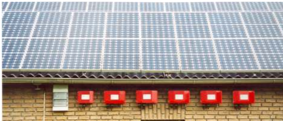
Abb. 22: Anordnung der Wechselrichter auf der Gebäudeaußenseite
